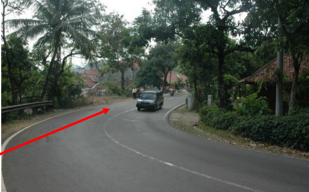
Gambar Prasarana 2 : Sekitar tempat kejadian marka tengah sudah buram
